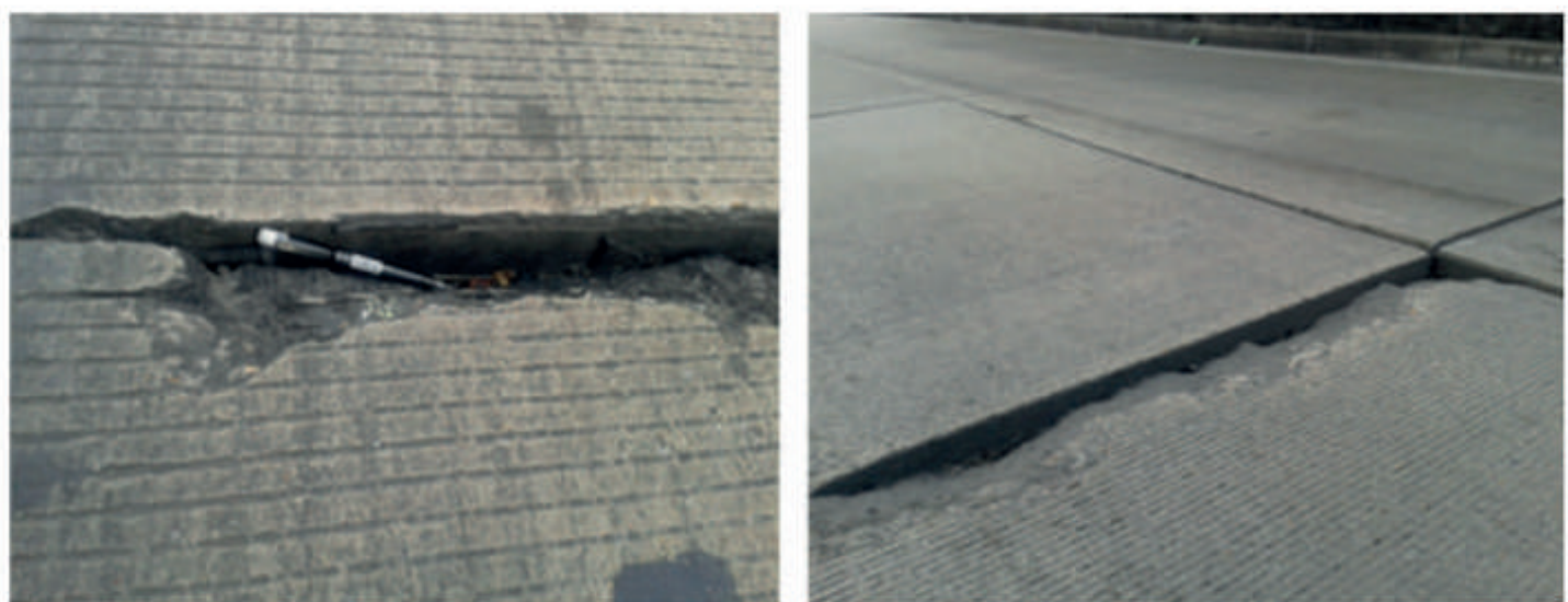
Figura 5. Desportillamiento mayor a lo largo de la junta de dilatación.
