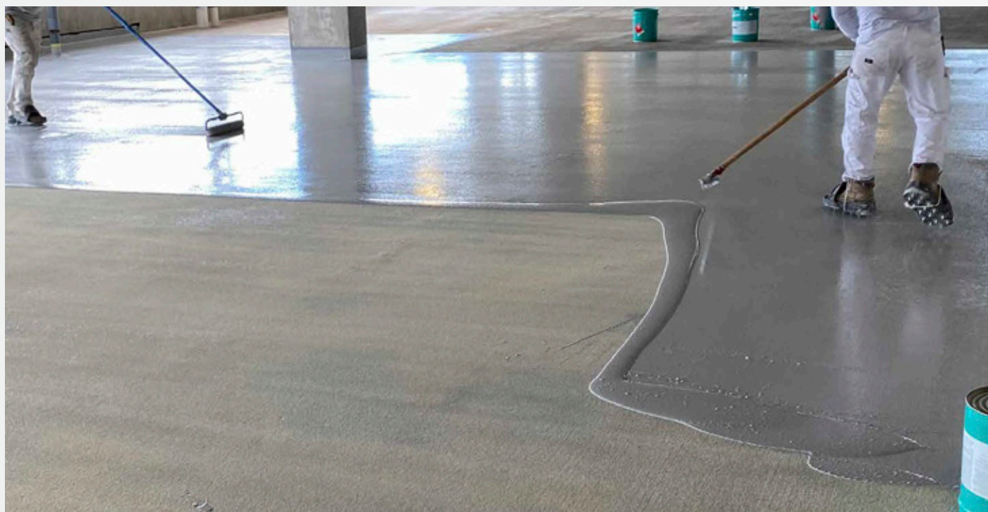
Aplicación de VULKEM 350 NF con squeegee y rodillo sobre la superficie, previa aplicación de VULKEM 171 PRIMER
