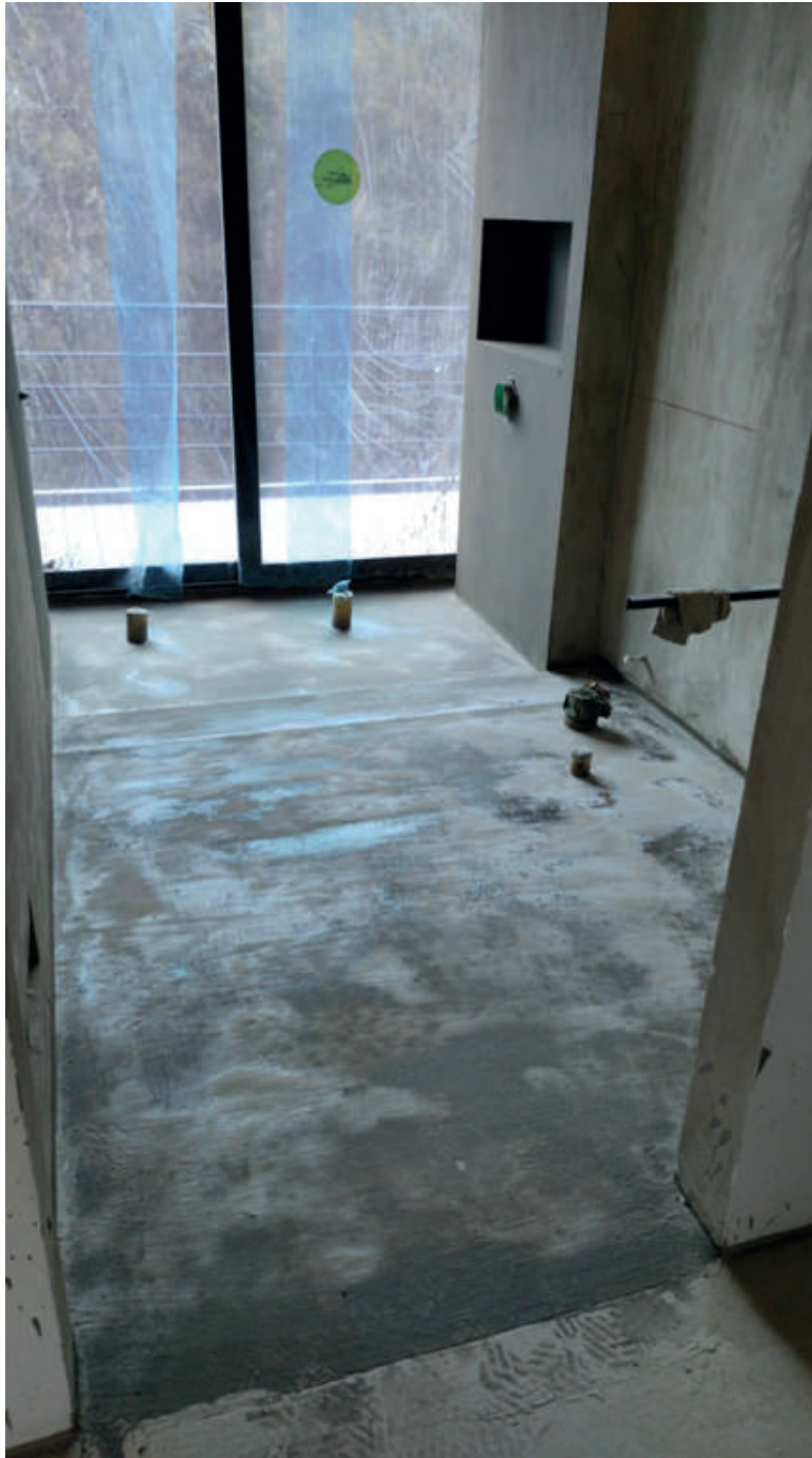
Figura 1. Baño antes del proceso de Impermeabilización
