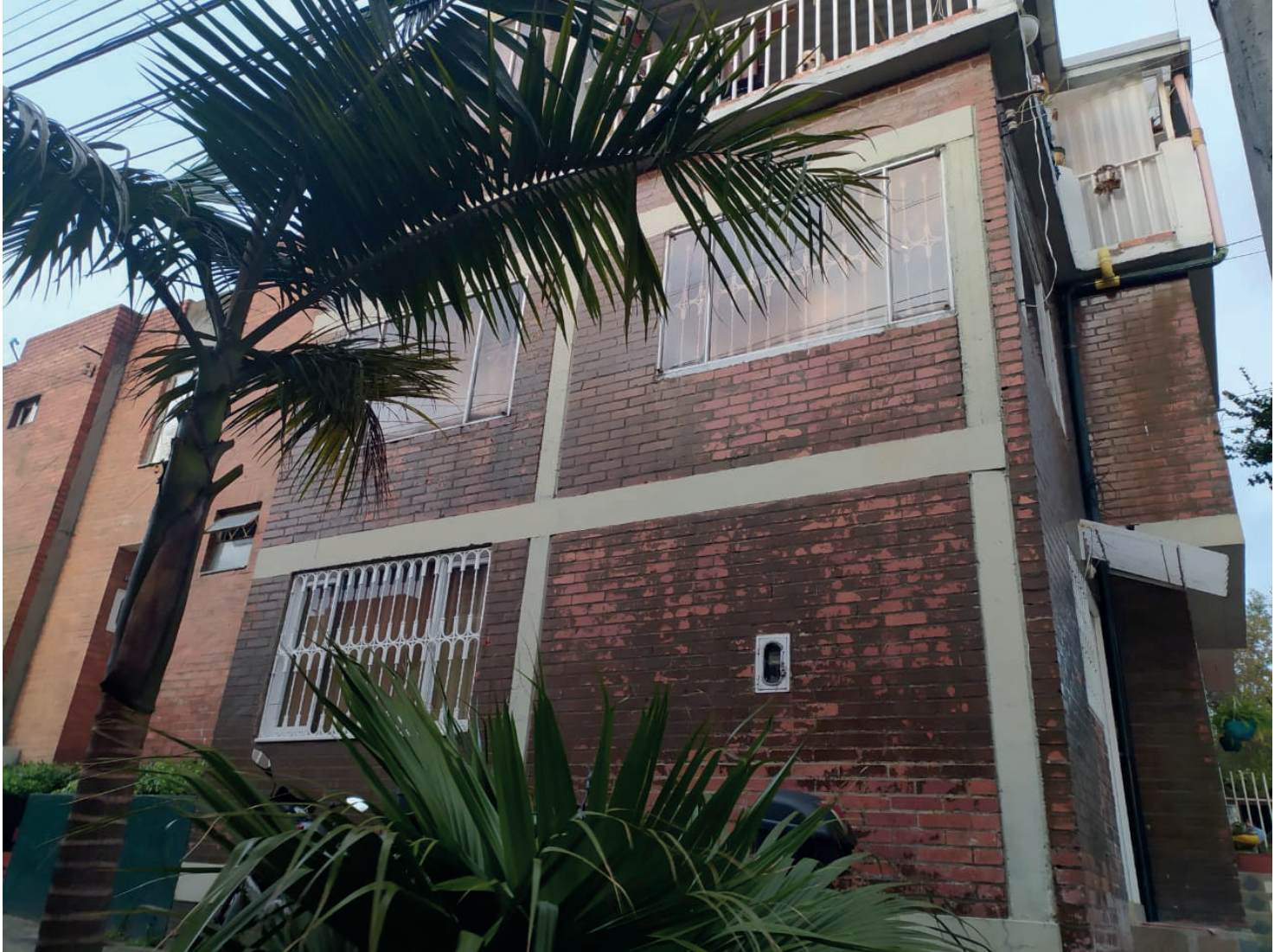
Deterioro de fachada en ladrillo por uso de barnices.
