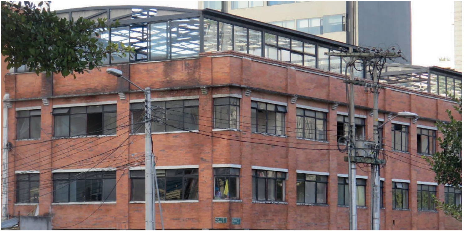
Manchas por contaminación atmosférica.
