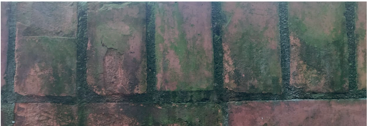
Mancha por crecimiento orgánico o vegetativo sobre fachada.
