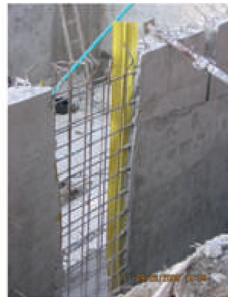
Inadecuada instalación de la cinta PVC
